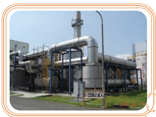
▲ 蓄熱式焚化爐設備，RTO
