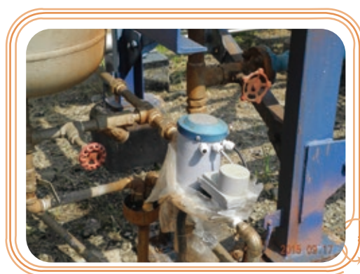
▲ 無耗氧卻水器設備
