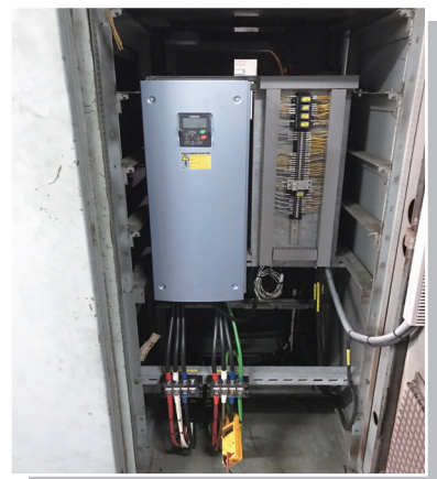
Line2 冰水機循環泵加裝變頻器
