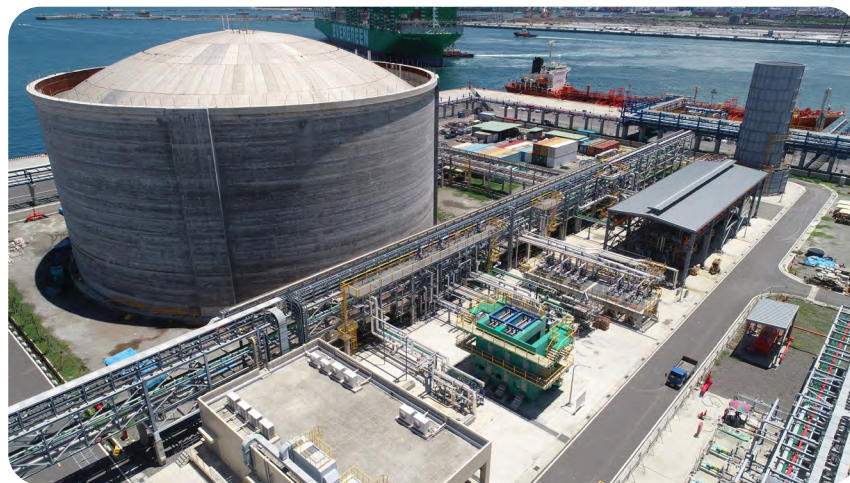
華運洲際二期廠區 - 乙烯儲槽區裝置
