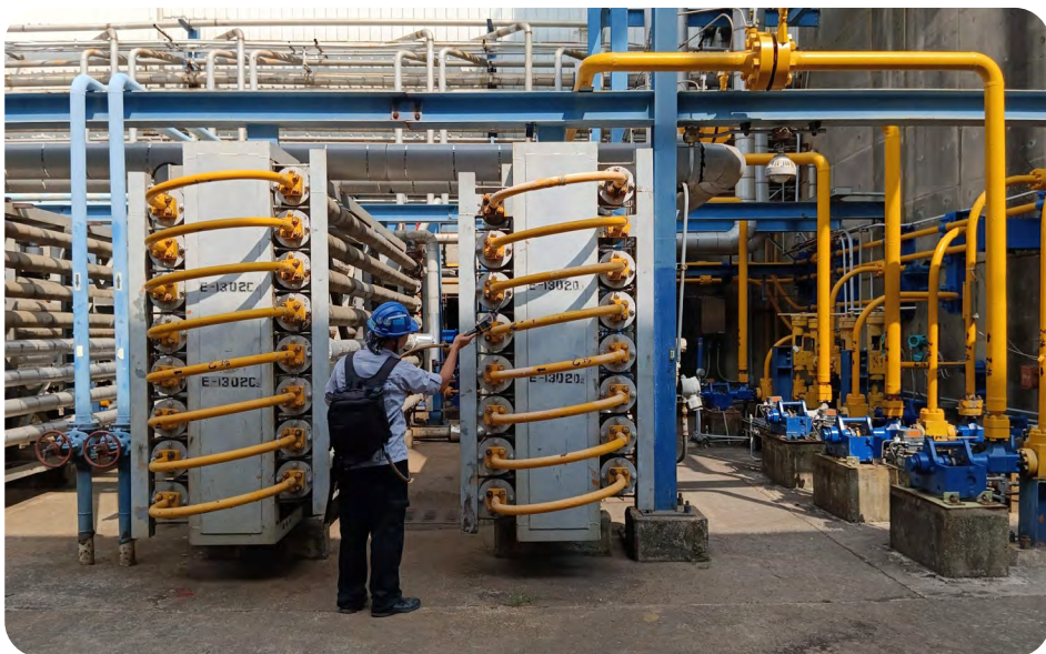
設備元件洩漏檢測
