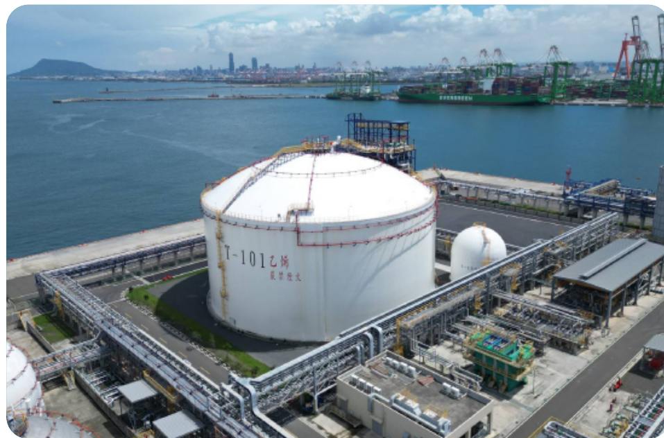
▲ 華運洲際二期廠區 - 乙烯儲槽區裝置
